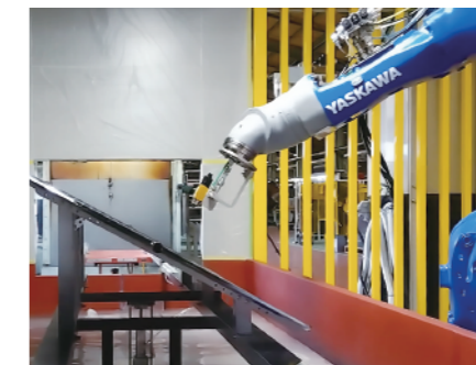
塗装ロボット設備
